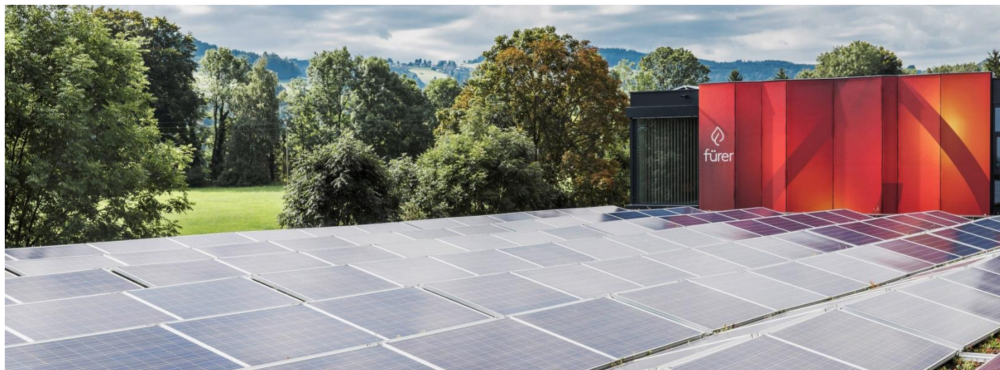
Photovoltaikanlage mit Ost/West Ausrichtung auf Verwaltungs- und Gewerbebau
